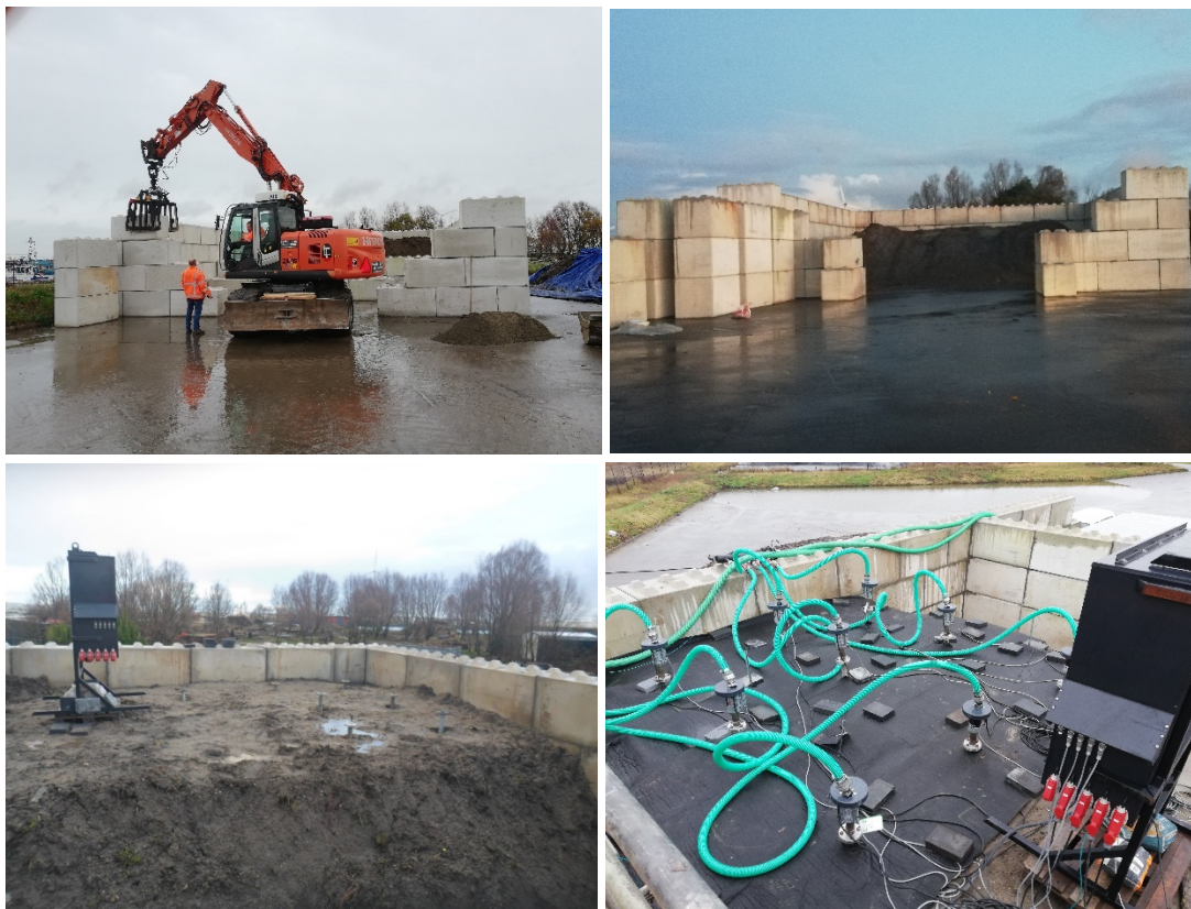
Figuur 11 Overzicht van de bouw en het vullen van het depot en installatie van de filterbuizen met heaters, luchtaanvoerslangen en bekabeling.
